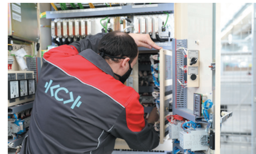
▲ Участок приемо-сдаточных испытаний на производстве пультов управления «Промтехмонтаж»
